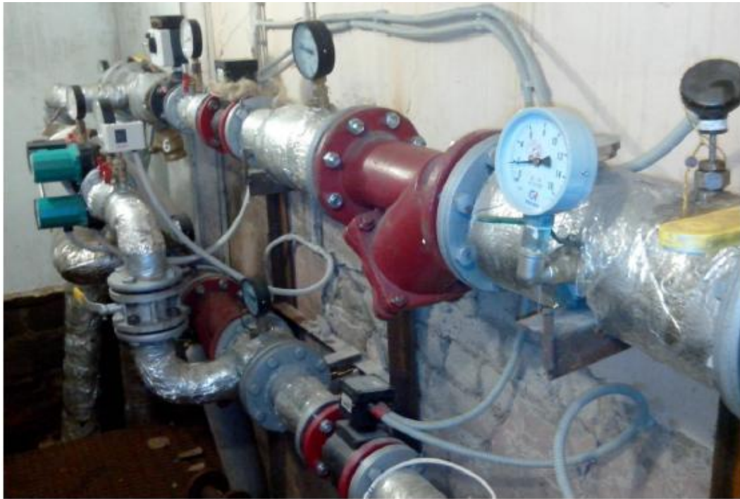
Рис. 4. Общий вид автоматизированного теплового пункта
